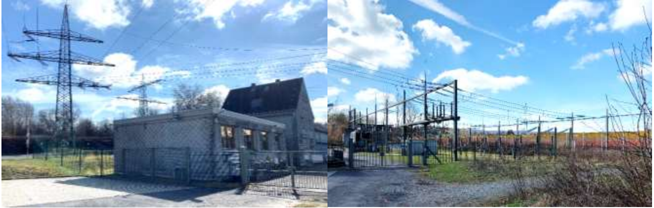
Elektroumspannwerke der RWE.
