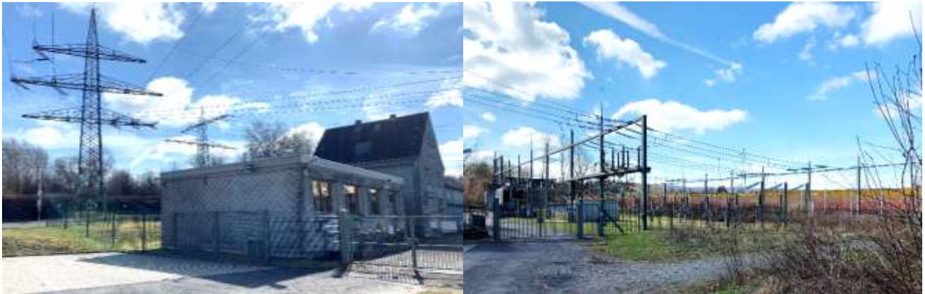
Elektroumspannwerke der RWE.
